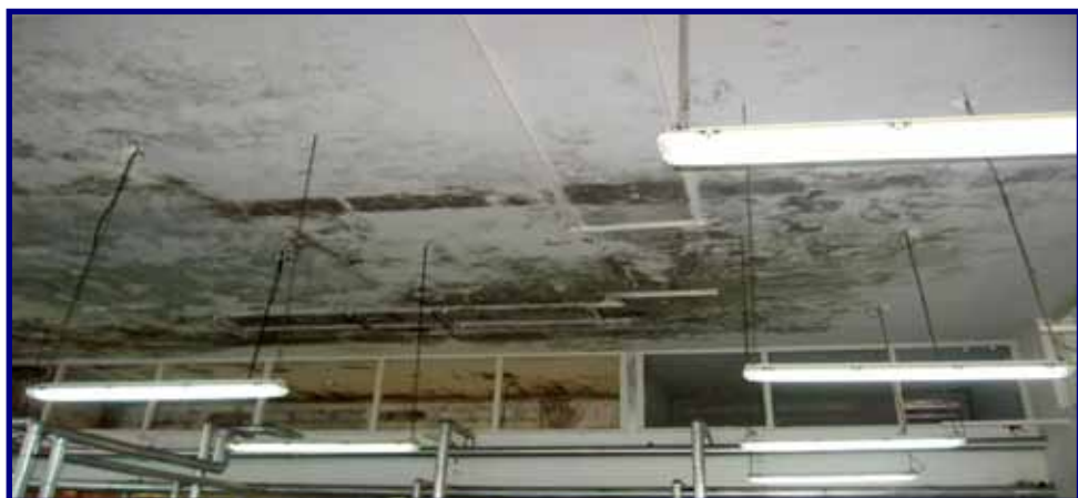
Slika 17. Oštećen strop kao posljedica loše ventilacije.
